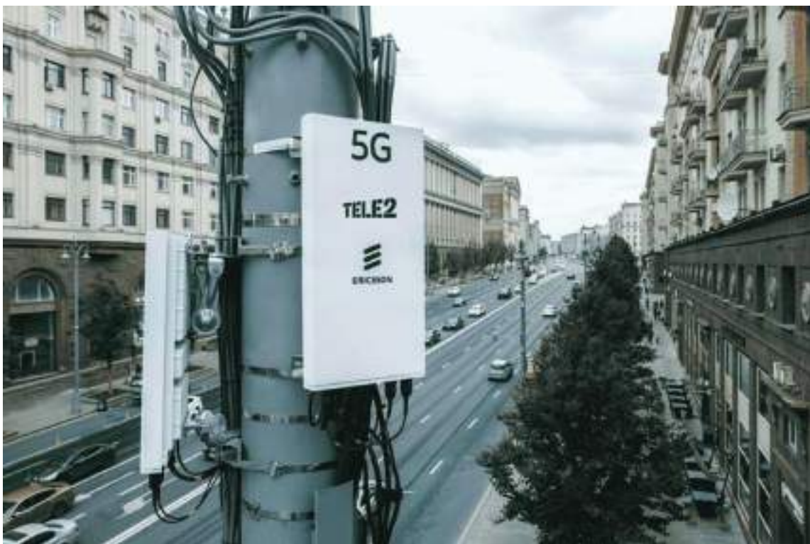
Рисунок 2. Передающая станция беспроводных сетей 5G на Тверской улице Москвы
