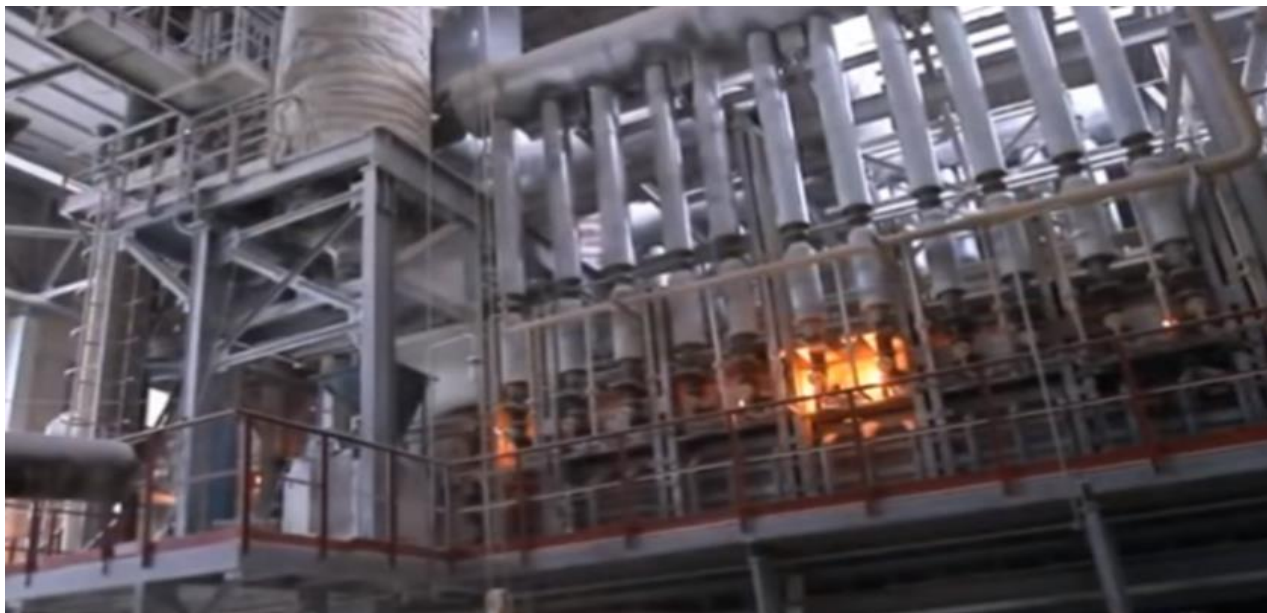
Фото 1 – Стекловаренная печь (вид на расстоянии)
